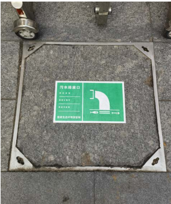
污水总排口及标识牌
