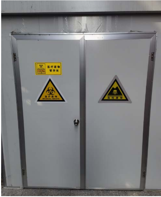
医疗废物暂存间及标识牌
